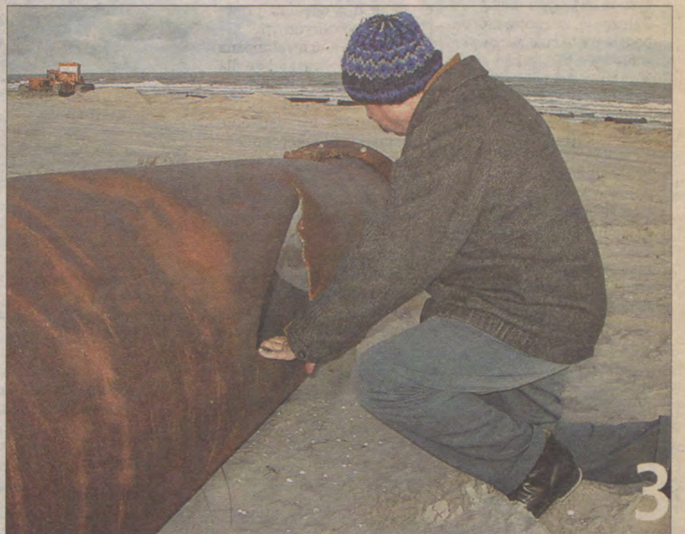
Na rurach refulacyjnych widać dziury powstałe w trakcie sztormu.
