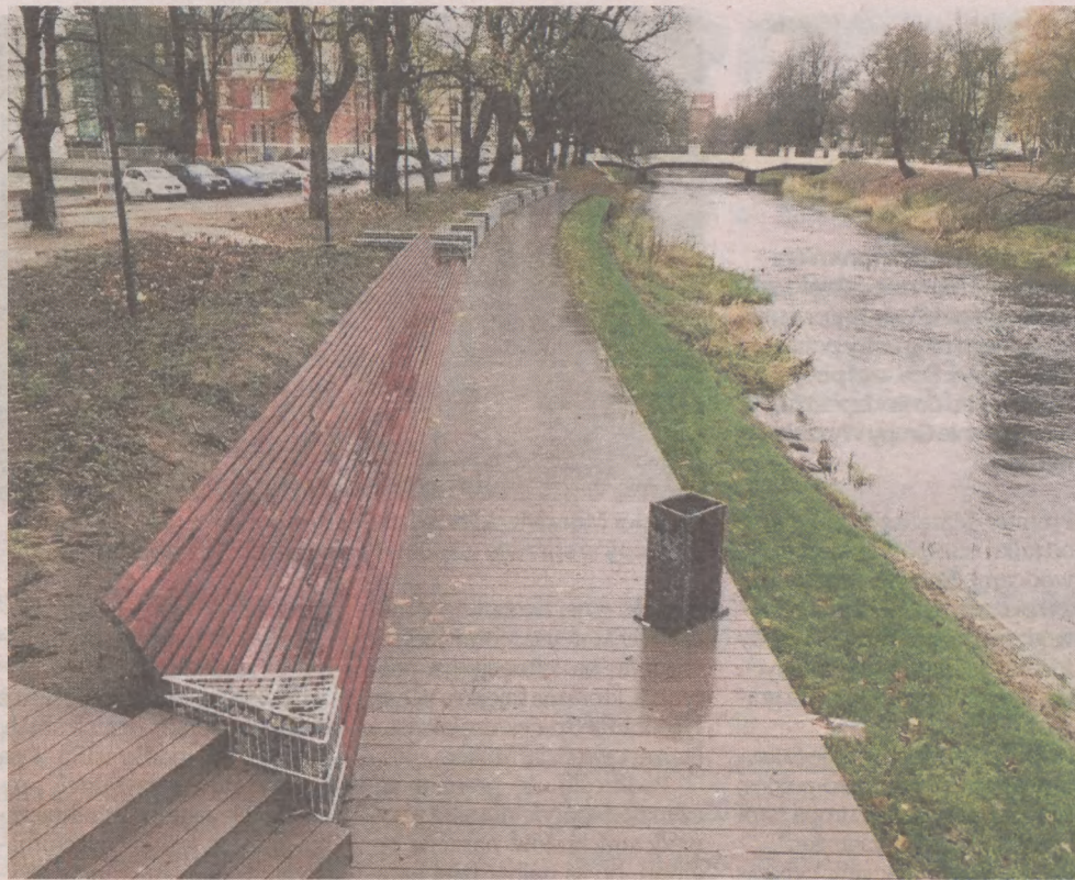
Budowa bulwarów nad Słupią trwa zgodnie z planem. Wykonawca zamontował już nawet przewidziane w projekcie ławki i leżaki. Już pierwszej nocy ktoś jednak odkręcił wszystkie śruby i przygotował te leżaki do kradzieży.
