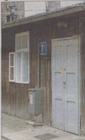
W budynku przy Spółdzielczej nikt już nie mieszka.
