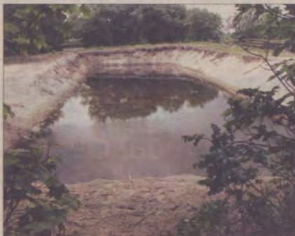
Tak wygląda miejsce pod budowę Domu Dziejowego w Gdańsku Brzeźnie. Dół nie jest zabezpieczony. Właściciel terenu od kilkunastu lat nie tam nie robi.
