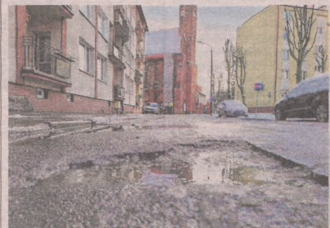
Poprawa stanu technicznego ulicy Mikołajskiej wymaga kompleksowej przebudowy tej ulicy - uważa dyrektor ZIM
