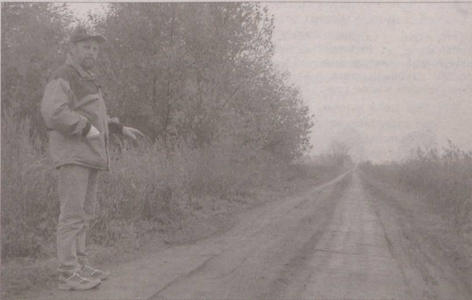
Henryk Gromnicki pokazuje dziury i porozsuwane płyty na drodze w Bystrej.
