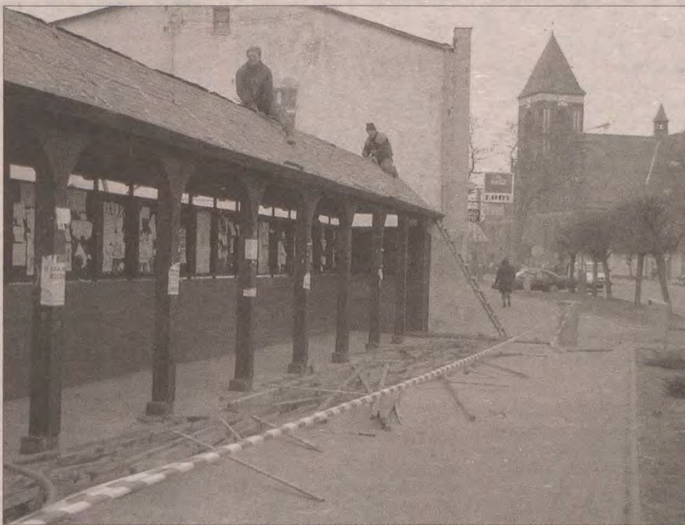
Powodem zdemontowania drewnianych arkad przy Urzędzie Miejskim w Czersku była zbyt wysoka cena dzierżawy terenu, na którym stały.
