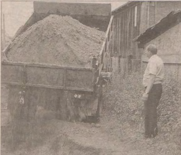
Kilkadziesiąt ton żwiru wsypano do dziury w drodze przed zabytkowym mostem.
