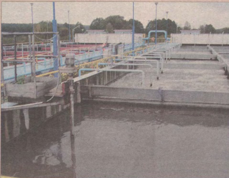
Oczyszczalnia ścieków w Przyborzycach wymaga modernizacji.
