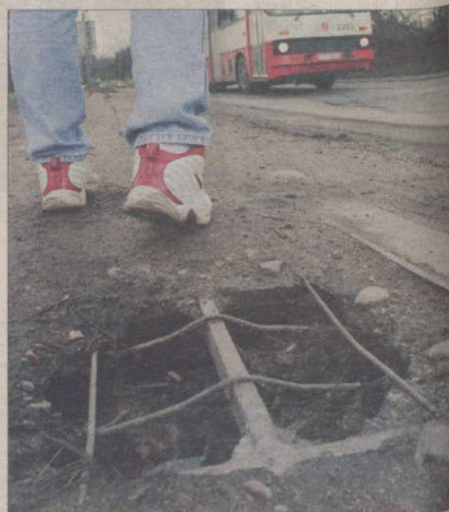
Idąc Traktem św. Wojciecha można wpaść w taką dziurę! Telekomunikacja obiecała zasypanie niebezpiecznych studzienek.
