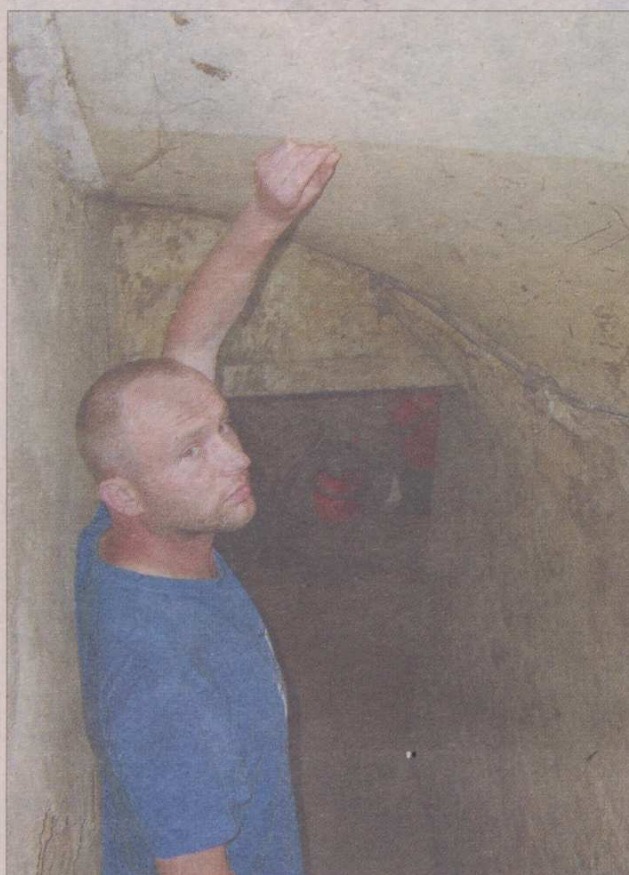
Gregorz Serwa pokazuje, dokąd sięgała woda podczas powodzi w 2001 roku. Od tego czasu nie osuszono piwnicy w kamienicy, w której mieszka.
