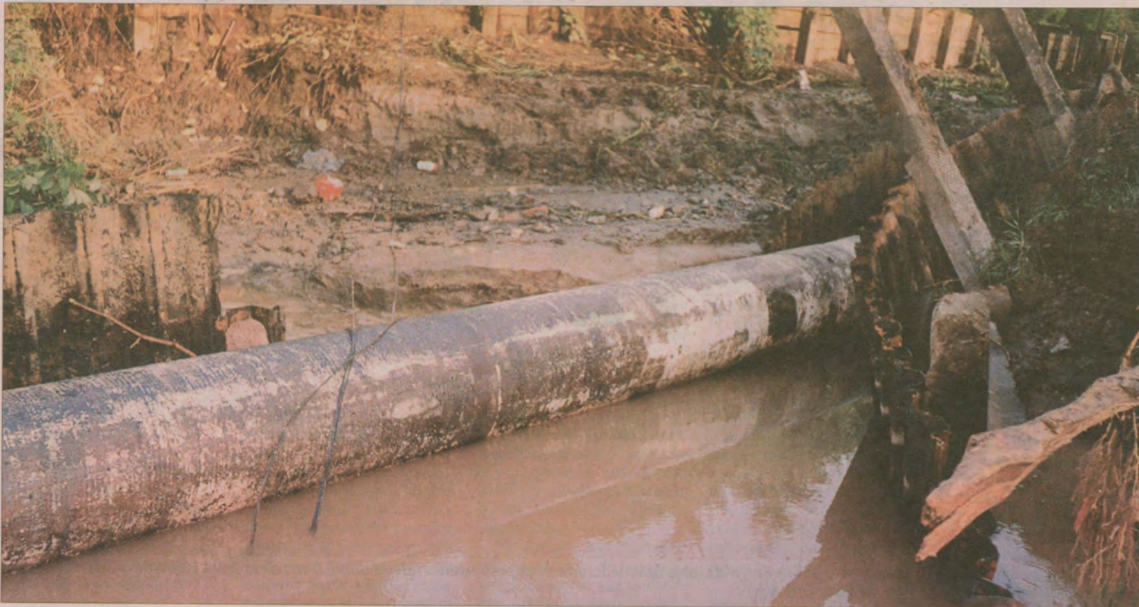
Kolektor kanalizacji sanitarnej w dnie Kanału Raduni.
