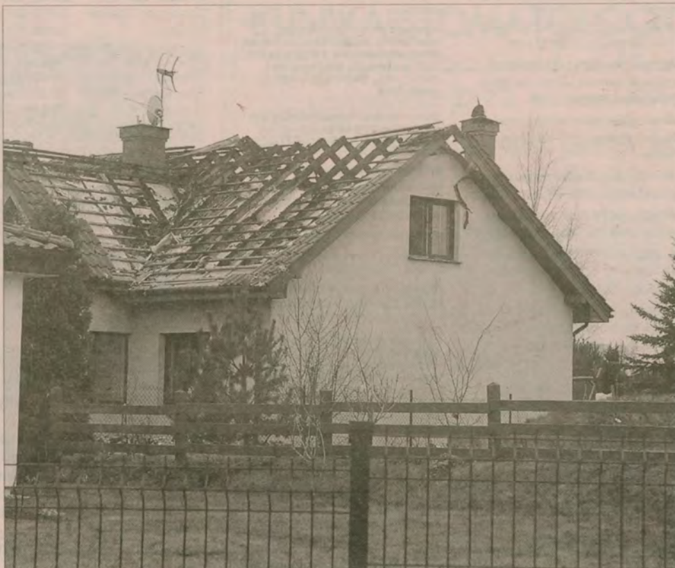
Dom nadaje się jedynie do remontu.
