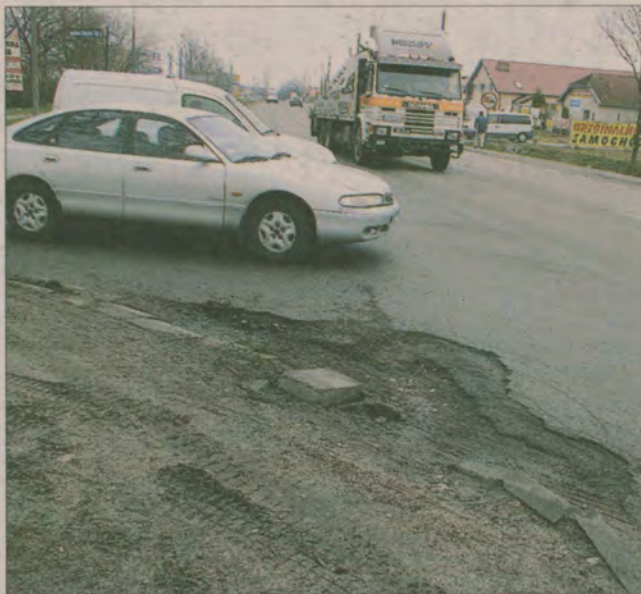
Wyrwa w asfalcie przy wjeździe na drogę krajową nr 1 w Pruszczu Gd. stwarza zagrożenie - twierdzą kierowcy.
