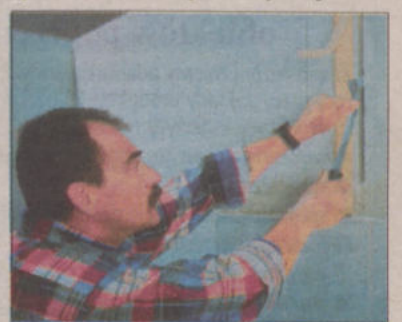
Bruzdownicę i otwornicę stosuje się w pracy w betonie komórkowym, młotek i przecinak przy pracy w cegle. Fot. materiały prasowe Xella
