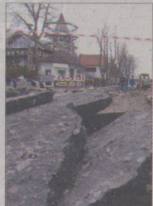
Szeroki pas zerwanej nawierzchni spowodował, że promenada straciła na święta swój urok.
