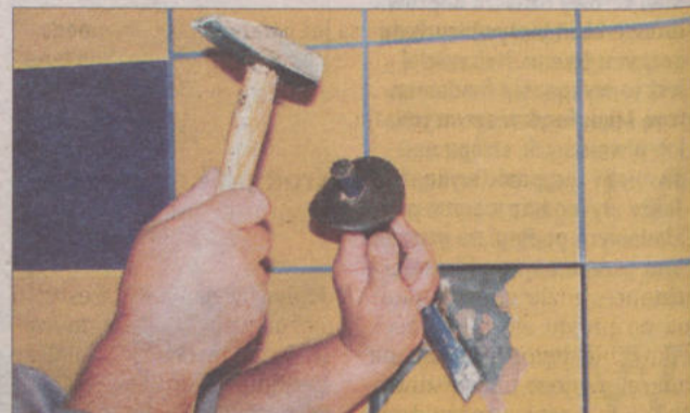
Po usunięciu fugi można przystąpić do rozbicia płytki, jedne odpadają łatwo, inne wymagają cierpliwości. Popękane części oraz stary klej usuwamy starannie, resztki pyłu wyciągamy odkurzaczem.
