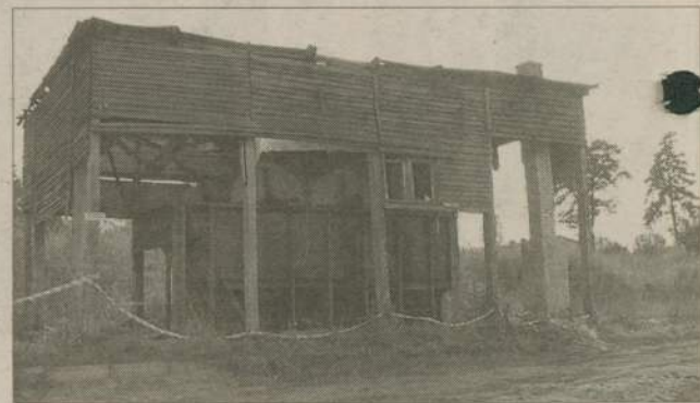
Trzeba dużo wyobraźni, aby nazwać konstrukcję w Płonicy oczyszczalnią.
