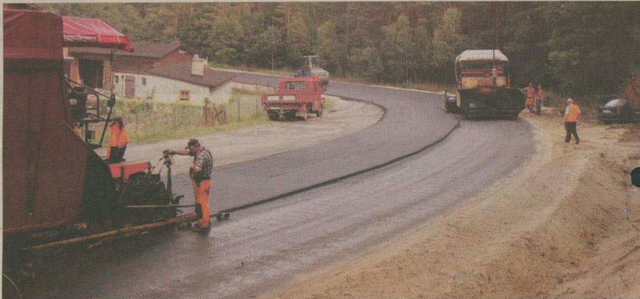
Dla zwiększenia bezpieczeństwa dokonano korekty łuków drogi.
