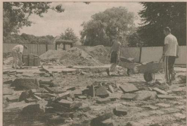
Pierwsze wątpliwości co do terminowości zakończenia prac pojawiły się już w sierpniu. Wtedy jednak termin zakończenia prac opiewał na koniec października...
